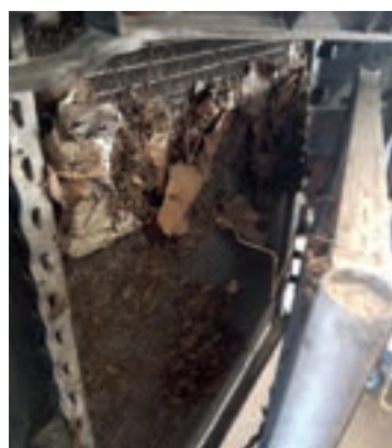
Schmutzansammlung zwischen Kühler und Kondensator
