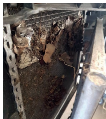
Schmutzansammlung zwischen Kühler und Kondensator
