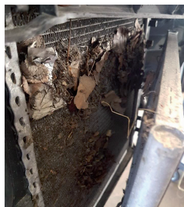
Schmutzansammlung zwischen Kühler und Kondensator
