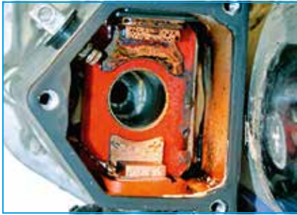
Розплавлена ізоляція проводів та знебарвлення корпусу. Запах горілого.
